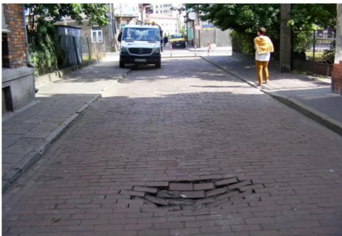
Fotografia 10. Przestrzeń niedostosowana do potrzeb różnych grup użytkowników. 14
